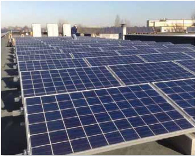
Techo con aplicación de lastre.
