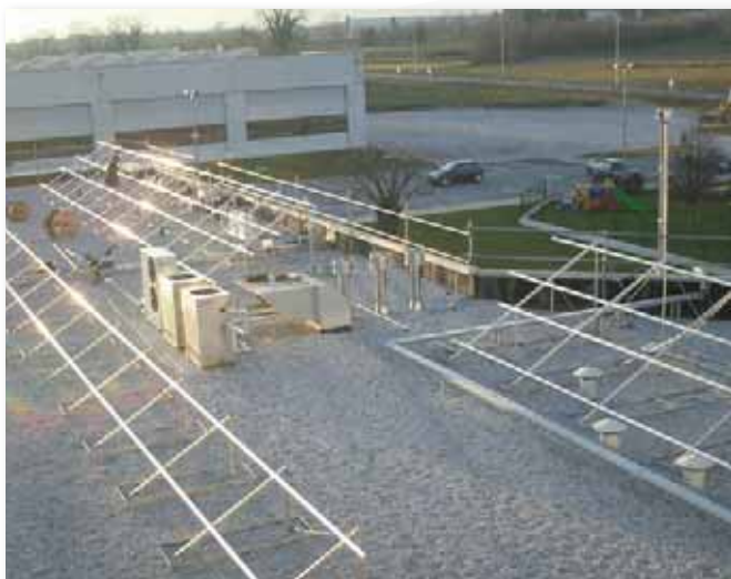
Techo industrial plano con grava. Aplicación con tanques de lastre FVT1455 y triángulos de 30° FVT1511.
