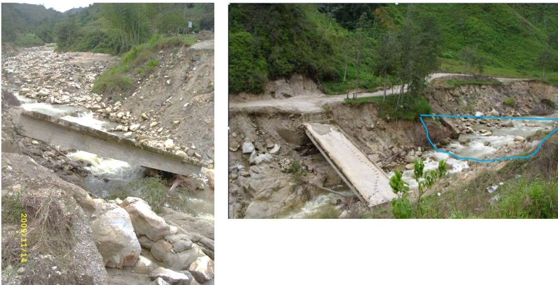
Foto 109. Destrucción del puente vial de la Quebrada San Pedro por avenida torrencial de 2009. (Fotos cortesía de José María Ruiz Palacio). Se destaca el área mojada del evento.
