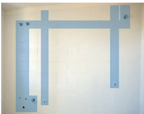
23. Bandas por donde discurren las instalaciones. Cocina.
