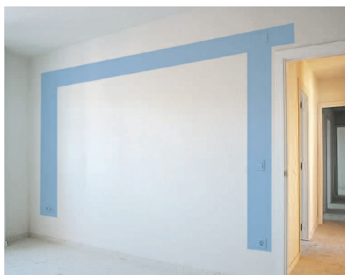
24. Bandas por donde discurren las instalaciones. Salón.
