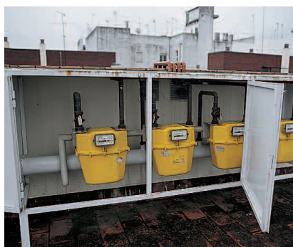
20. BATERÍA DE CONTADORES Y LLAVES DE CORTE.
