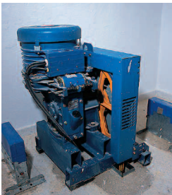
13. MAQUINARIA DE ASCENSOR.
