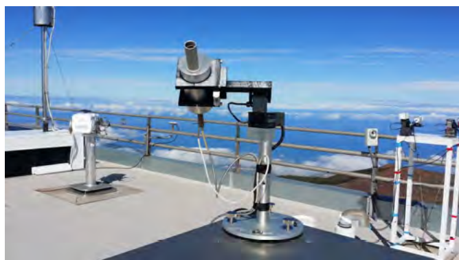
Figura 6.10. El Pandora 121 instalado en el IZO.
