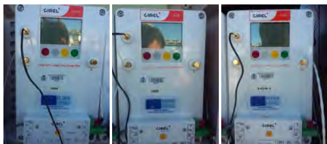
Figura 9.4. Cajas electrónicas de los tres fotómetros CE318-T de Cimel (# 1089, # 1090 y # 1091).
