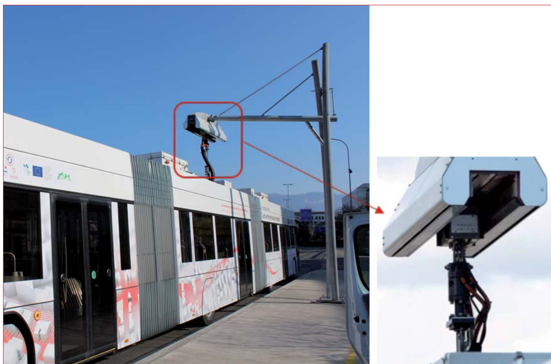
Figura 7 Ricarica ultrarapida (flash charging) delle batterie tramite pantografo in corrispondenza della fermata selezionata
