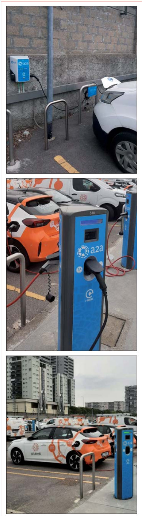
▲ Figura 2 Stazioni di ricarica e wallbox installati nell'E-hub di Unareti - Fonte Unareti
