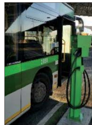
Figura 9 Punto di ricarica per autobus elettrici realizzato presso il deposito ATM di San Donato Milanese
