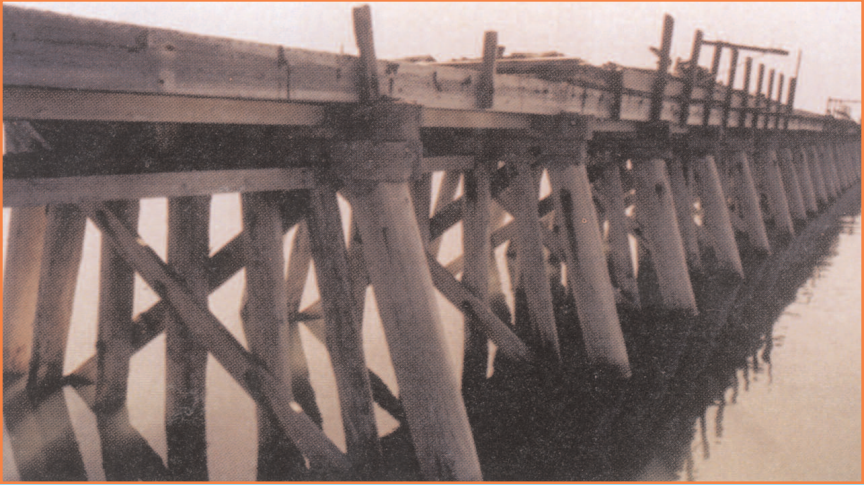
Puente original de ferrocarril que atravesaba el Gran Lago Salado, construida aproximadamente 1903. Foto por June Cannon, Cannon Structures, Inc.. Una operación de salvamento para la madera empezó en 1993. Se usó una parte de la madera en el vestíbulo del Departamento de Recursos Naturales.
