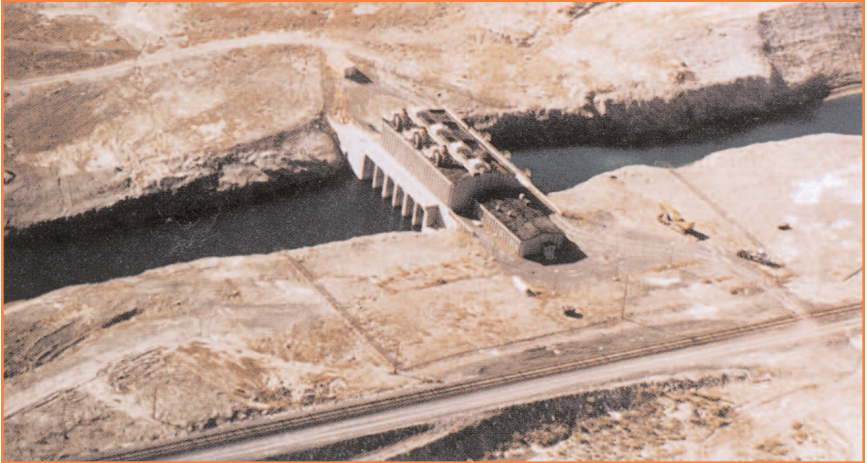
Instalación de bombear del desierto del oeste. El agua se estaba bombeo del brazo norte del lago por un canal de 4.1 millas a la Estanque Oeste de 320.000 acres.
