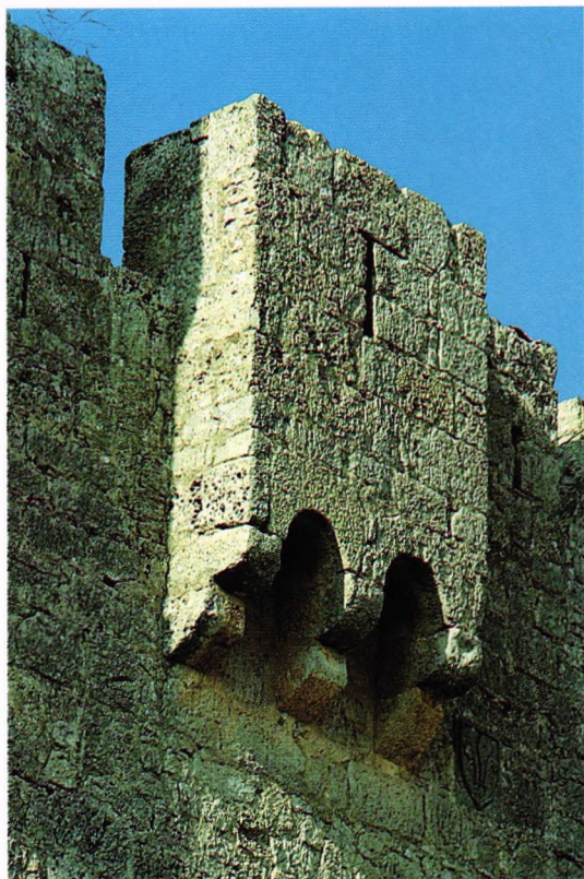
Fig. 134.- Castillo de Olmillos de Sasamón (Burgos). Ladronera sobre un acceso en el sector meridional del recinto interior, de mediados del siglo XV, obra probable de Pedro de Cartagena, hijo del Obispo de Burgos, el judeoconverso Pablo de Santa María.
