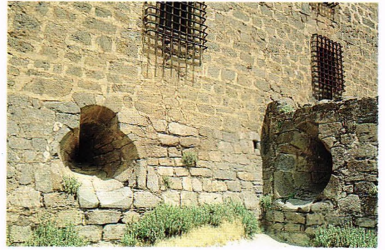
Fig. 265.- Castillo de La Calaborra (Granada). Troneras con un acusado abocinamiento externo, en el cubete artillero (ver fig. 95) y el resalte occidental de esta fortaleza granadina, construida hacia 1509 por el I Marqués del Cenete. El efecto de abocinamiento se potencia el cortar el plano inclinado del alambor.
