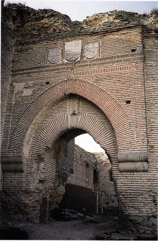
Fig. 63.- Castillo de Casarrubios del Monte (Toledo). Buzón matafuego sobre el acceso principal, labrado por Ali Caro, hacia 1496, para don Gonzalo Chacón.
