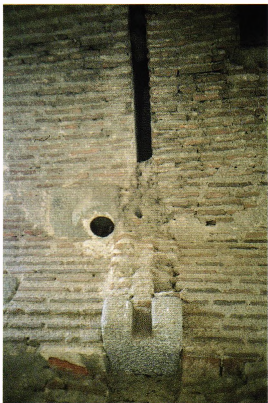
Fig. 203.- Castillo de Casarrubios del Monte (Toledo). Intradós del pasaje al acceso principal, en el que la ranura del rastrillo corta la plementería latericia, en cuyos salmeres se encastra la pieza de granito aborquillada para encarrillar el descenso del peine. Fue construida hacia 1496 por el mudéjar abulense Ali Caro según trazas del titular de la fortaleza don Gonzalo Chacón, y el rastrillo debió ser obra del herrero toledano Alonso Díez de Aguilar.
