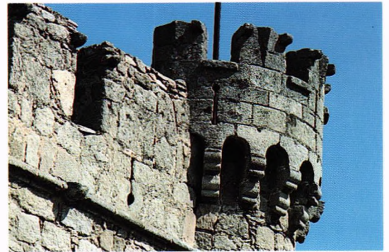
Fig. 140.- Castillo de Oropesa (Toledo). Primer plano de merlatura, en adarve y escaraguaita, mostrando las ranguas horizontales para encastrar el eje de los manteletes que cubrirían a voluntad las almenas. Esta pequeña fortaleza debió ser construida en el último tercio del siglo XV, aunque afectada pocos años después por el asalto de las fuerzas imperiales, en Marzo de 1521, cuando era de los Pérez de Guzmán.
