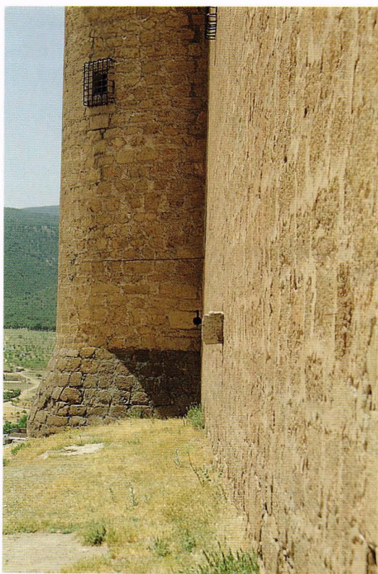
Fig. 206.- Castillo de La Calahorra (Granada). Vista sesgada del lienzo oriental y el cubo sureste, mostrando la interposición del rediente deflactor entre las trayectorias rasantes al muro y convergentes entre sí de los disparos perpendiculares a las dos troneras de «palo y orbe» que, enfrentadas, se abren en los cubos esquineros, justo por encima del alambor e inmediatas al lienzo.
