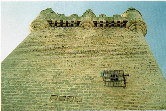
Fig. 144.- Castillo de Torrepadierne (Burgos). Matacánes sobre modillones y entre escaraguaitas de soporte abocelado, en el terrado del macho de este extraño híbrido de castillo y casa-fuerte, que estaba labrándose aún entre 1519 y 1524 para los Valdivielso, y que fue objeto de interdicción regia a instancias de justicia y regidores de la ciudad de Burgos, obligándose al derribo de la falsabraga y puente levadizo, así como a destruir y colmatar el foso, pero dejando intacta la torre del homenaje, aún hoy una de las mejor conservadas de Castilla. En 1510 se guardaba en ella «tiros de polbora e lombardas e zerbatanas mayores e menores, e truenos e espingardas e ballestas fuertes e de pie ... e escalas de escalar», aunque cuarenta años después, pasadas las Comunidades, «se deshicieron ciertos tiros pequeños de artillería de dicha torre, parte de los arcabuces y capaçetes ... quebrados por su inutilidad para hacer rejas y clavos»... Todavía en la segunda mitad del siglo XVIII el Marqués de Barriolucio tenía emplazados cuatro cañones en las escaraguaitas esquineras de la torre. En la imagen se perciben, bajo el nivel de la ventana enrejada, los escudos de armas de Avellaneda, Valdivielso, Ulloa y Varona.
