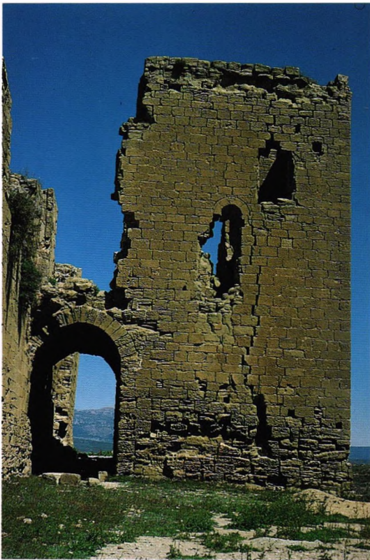
Fig. 232.- Castillo-abadía de Montearagón (Huesca). Torre albarrana en el sector sureste, quizás de hacia 1200, con un emplazamiento muy similar a la de Zorita de los Canes, adolece de una patología estructural coincidente (fotog. de 1977). Forma parte de una fortaleza monástica con vida regular desde fines del siglo XI, fenómeno castral frecuente en los balbucesos del Reino de Aragón, que en esa misma centuria ofrece precedentes como Loarre y Alquézar.
