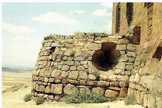
Fig. 95.- Castillo de La Calaborra (Granada). Cubete adosado al frente occidental de la fortaleza, casi al borde de una empinada ladera que no puede ser batida al quedar desenfilada por unas trayectorias excesivamente altas, mientras que el resto de la meseta donde se emplaza el propugnáculo sólo puede ser hostilizada desde su cañonera septentrional, y ello marginalmente. Además, el cubete no tiene más acceso que el cenital, sin comunicación alguna con el interior de la fortaleza, y con muestras inequívocas de abandono en su ejecución.
