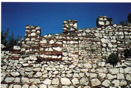
Fig. 150.- Fortaleza de La Calahorra (Gibraltar). Merlatura cegada correspondiente a un adarve horizontal, y erección de otra con proporciones simbólicas más que funcionales, en el antepecho del adarve ahora inclinado. Sector noreste, entre la torrepuerta y la del homenaje. Aunque sin fechar, ambos niveles deben corresponder a reformas cristianas en la alcazaba merinida-nazarí.
