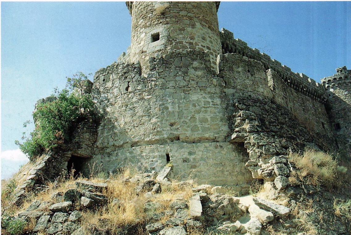
Fig. 14.- Castillo de Mombeltrán (Ávila). Falsabraga construida hacia 1477 por el Duque de Alburquerque, engrosada exteriormente en las primeras décadas del siglo XVI con un extraño alambor abuecado por una manga perimetral, que sin duda debilitaría el acondicionamiento pirobaleístico previsto al adosar el forro atalutado.
