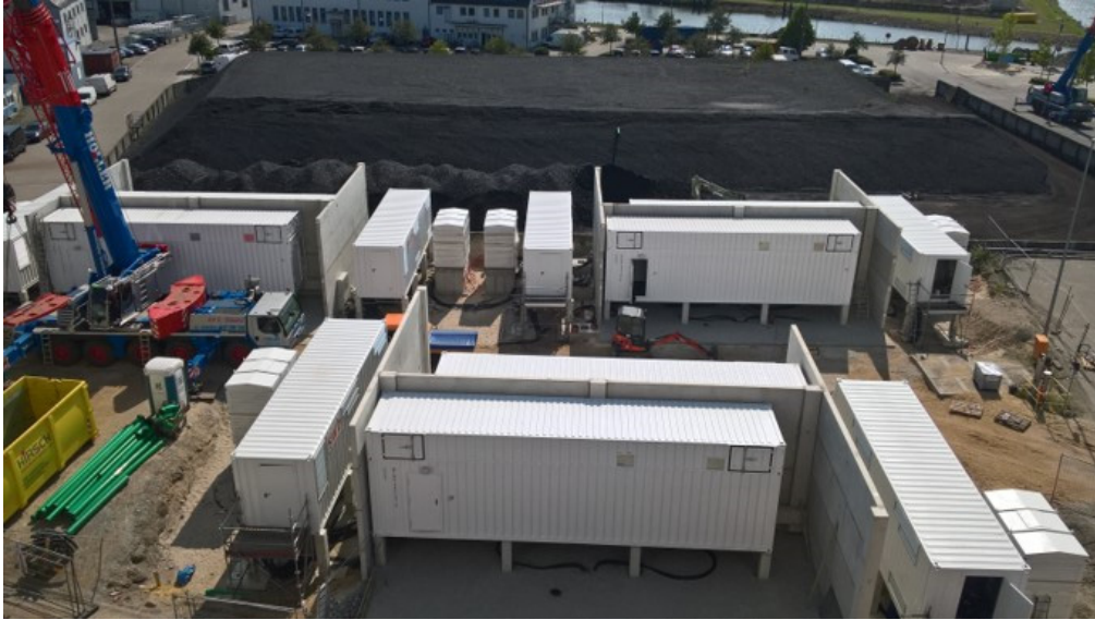
Figura 6. Foto realizada durante la instalación - contenedores de baterías, contenedores de conversión de energía con los SC-FLEX de AEG PS, transformadores ya en su lugar, obra civil todavía en proceso. En la parte trasera se puede ver el búnker de carbón para la central eléctrica convencional.
