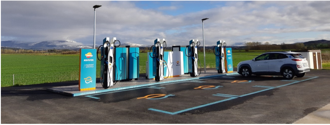
Figura 4. E.S. Lopidana con 4 terminales de hasta 350 kW.
