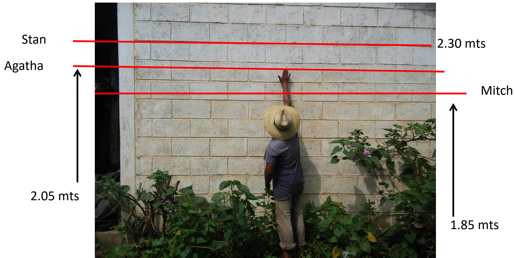
Vestigios de la altura alcanzada por las inundaciones en la comunidad LB20, San José La Máquina, Suchitepéquez.
