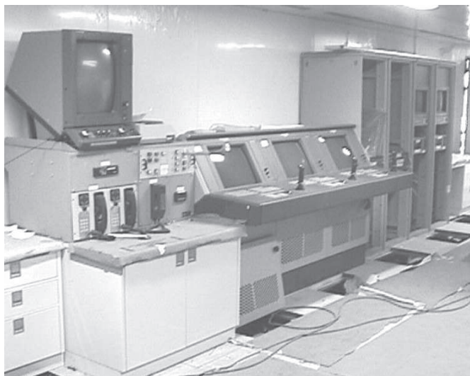
Figura 13.- Sala de Control del sistema de DP (en proceso de construcción)
