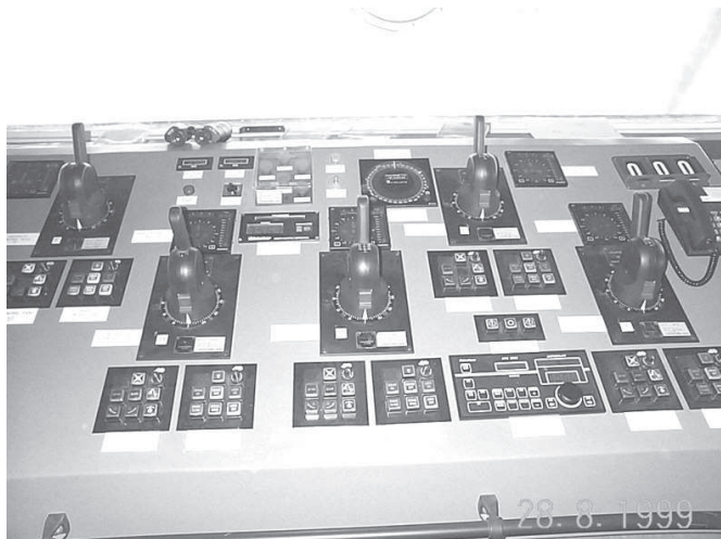
Figura 12.- Detalle del control de los propulsores azimutales desde el Puente de Mando
