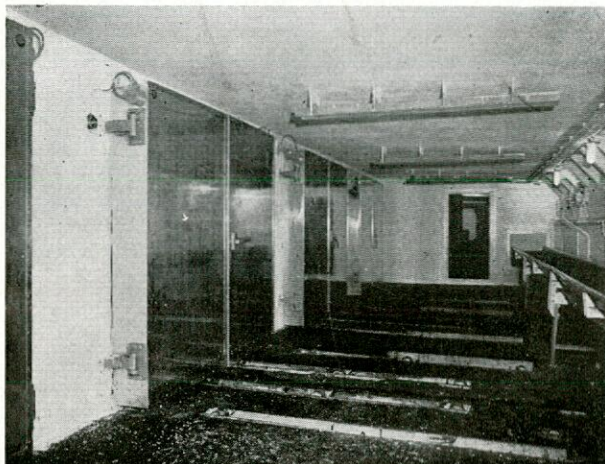
Antecámara de los túneles de congelación
