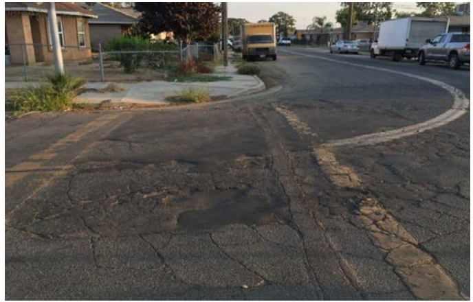
La calidad del pavimento está deteriorándose y las marcas están descoloridas en la avenida S. Santa Clara y la avenida E. Chester.
