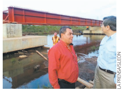
El ministro Pablo Fernando Martínez (derecha) espera que la construcción del puente Suampo de Lara concluya en octubre.
