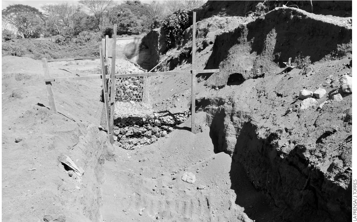
Este proyecto de emergencia, que consiste en “estabilización de taludes”, comenzó hace unas dos semanas en el barrio de El Jobo. Debía estar listo a más tardar en enero.
