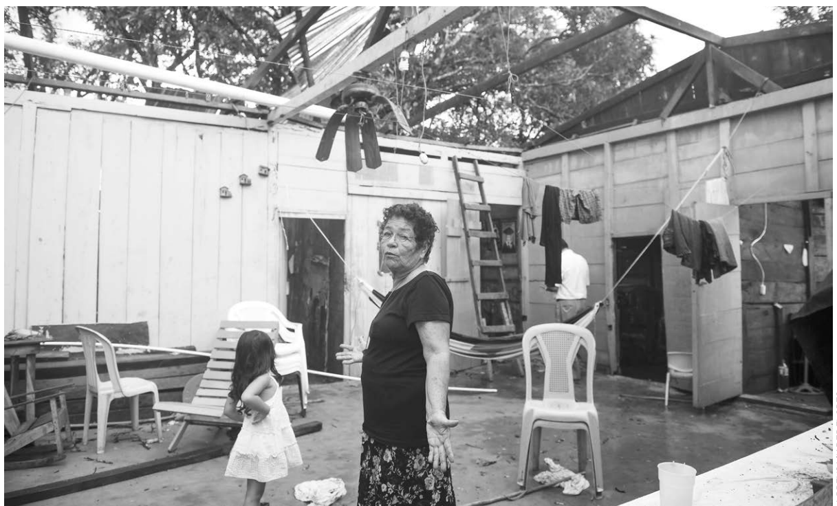
El techo de la vivienda de doña Juana Reyes fue arrancado por los fuertes vientos que provocó el huracán Otto, en San Carlos.
