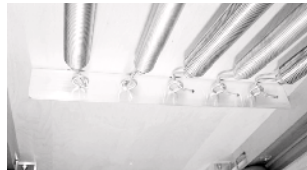
Figura 3: Tensores enganchados hacia abajo
