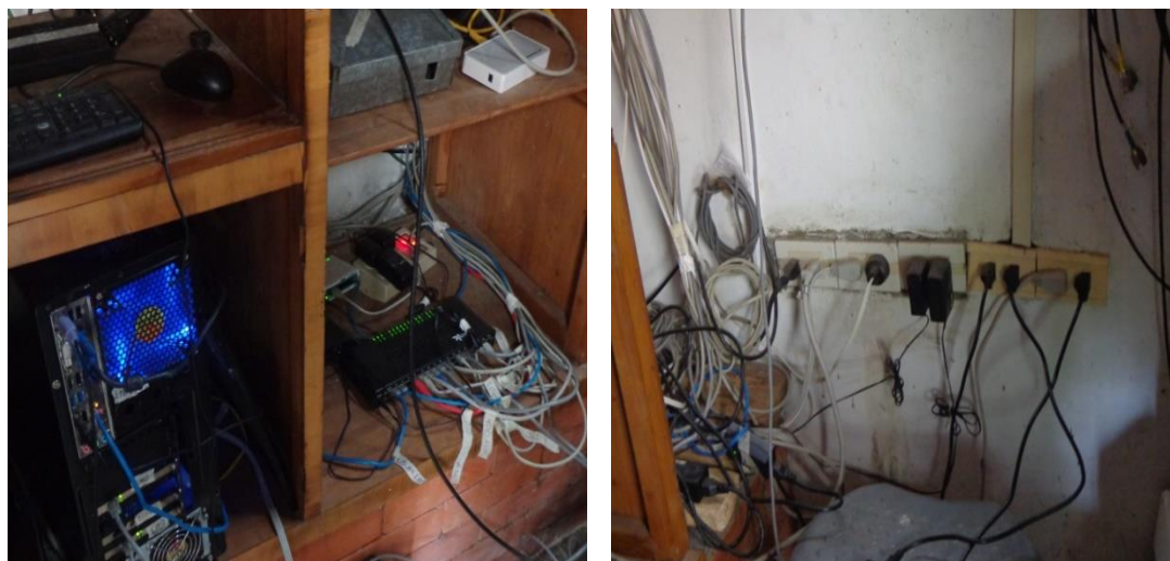
Figura 19. Estado de las Conexiones
