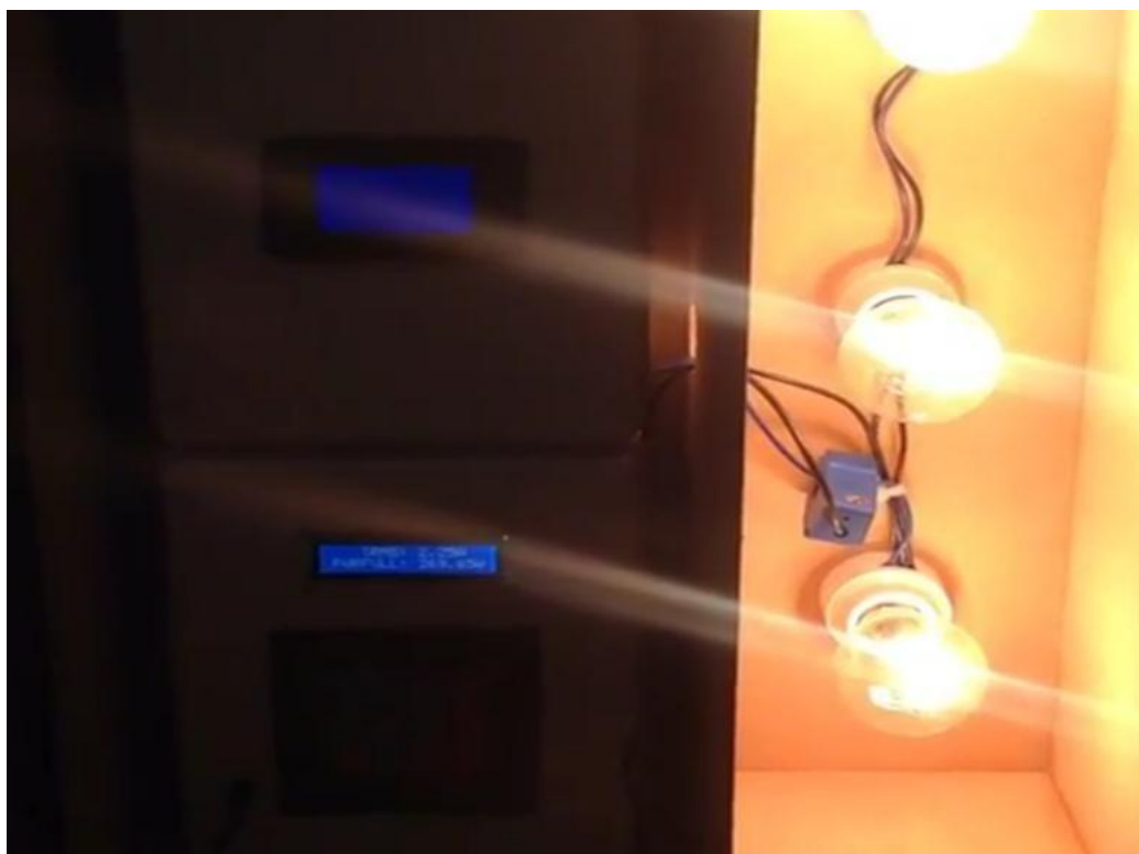
Anexo 2 figura 6 medidor en funcionamiento.
