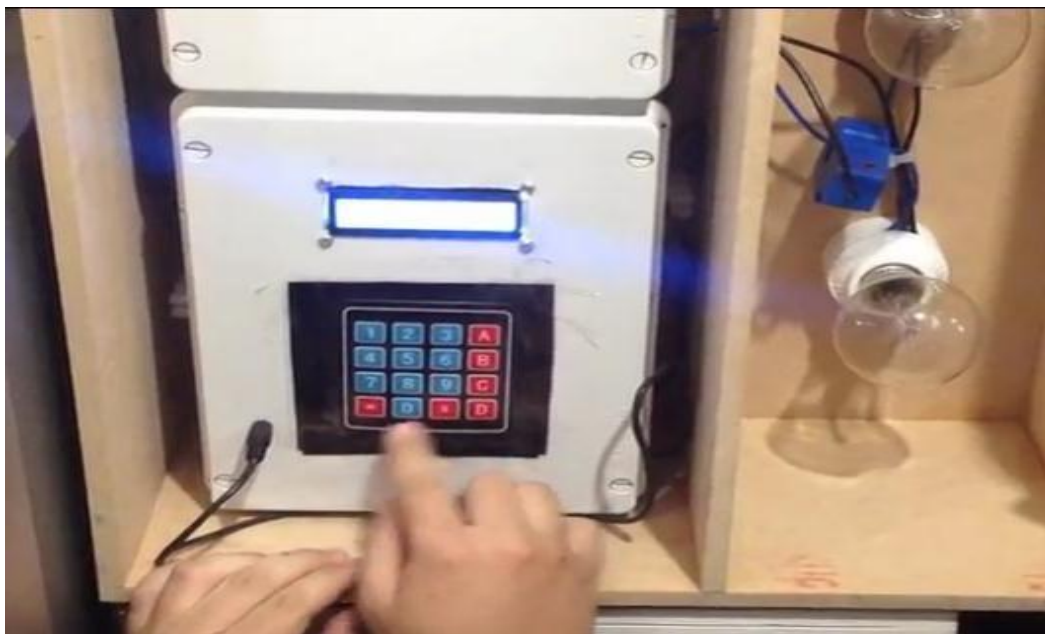
Figura 45. Manejo del medidor de energía prepago por medio de teclado.
