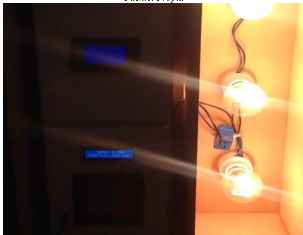
Figura 46. Medidor en funcionamiento.
