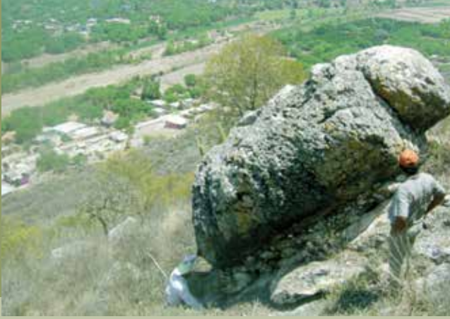
Figura 4. Bloque de caliza con más de 20 toneladas de peso sobre una ladera en la comunidad La Reformita, Ciudad Fernández. La escuela se ubica en la línea hipotética del trayecto de este bloque, de darse una caída o rodamiento.
