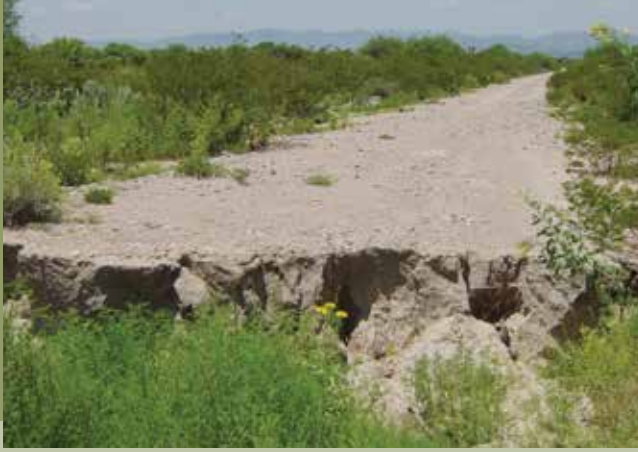
Figura 2. Camino rural cortado por una grieta en la Delegación de Bocas, norte del municipio de San Luis Potosí.
