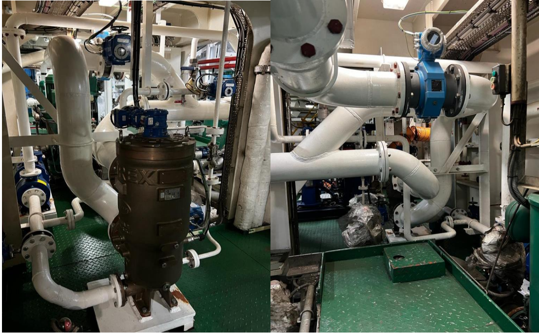
Ilustración 8 Colectores de tuberías de lastre hacia el BWMS Fuente: Elaboración propia
