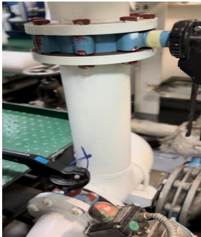
Ilustración 9 Válvula bypass y precinto Fuente: Elaboración propia
