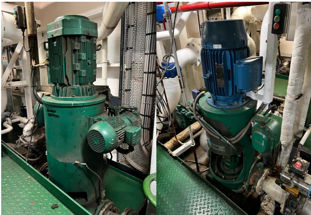
Ilustración 7 Bomba de lastre Nº1 y Nº2 Fuente: Elaboración propia
