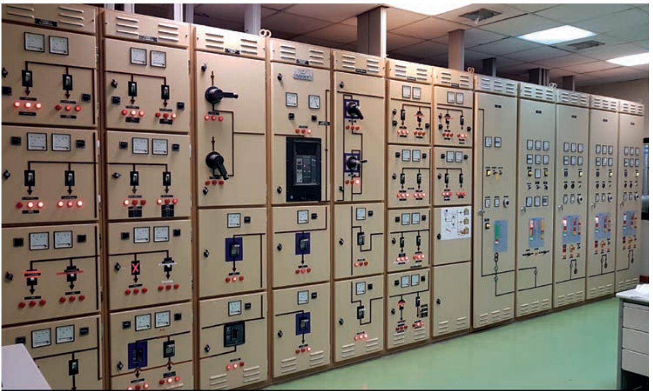
Cuadros eléctricos de la sala de control grupos
