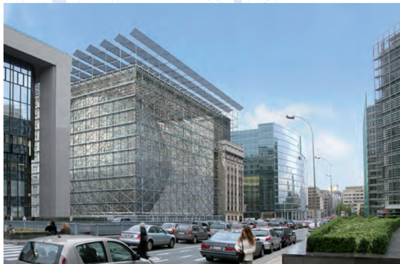
Así quedará la sede del Consejo Europeo cuando terminen las obras que están en la última fase de su realización.
