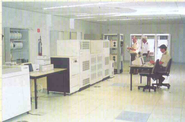
Sala de ordenadores del Sistema de Producción. La información bruta procedente del satélite se transforma en productos normalizados libres de errores.
