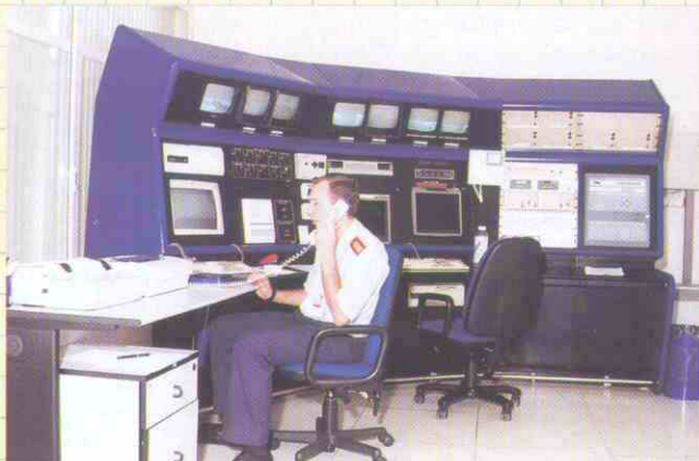
Control de Seguridad. El control de accesos y los sistemas de seguridad física del Centro se encuentran completamente informatizados.
