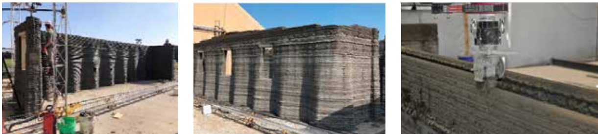
Barracones de hormigón proyectado con impresora 3D en el marco del programa estadounidense "Automated Construction of Expeditionary Structures" (2017)
