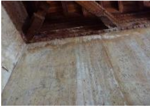
Figura 9. Muro en eje A con escorrentía.
