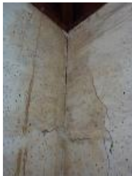
Figura 14. Grieta de 2 cm de ancho en intersección de ejes A-1.
