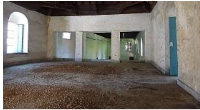
Figura 13. Suciedad en los muros producto de los excrementos de murciélagos y en el local producto de restos de sus alimentos.
