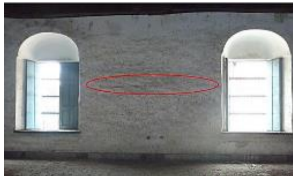
Figura 15. Grietas horizontales en la parte baja de muro (eje 1).
