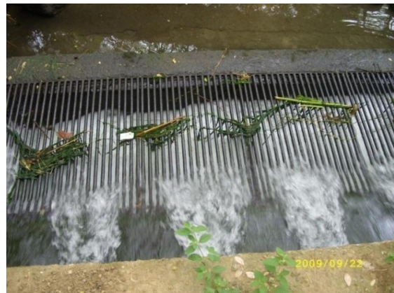
Imagen 4. Bocatoma de fondo municipio de Palmira
