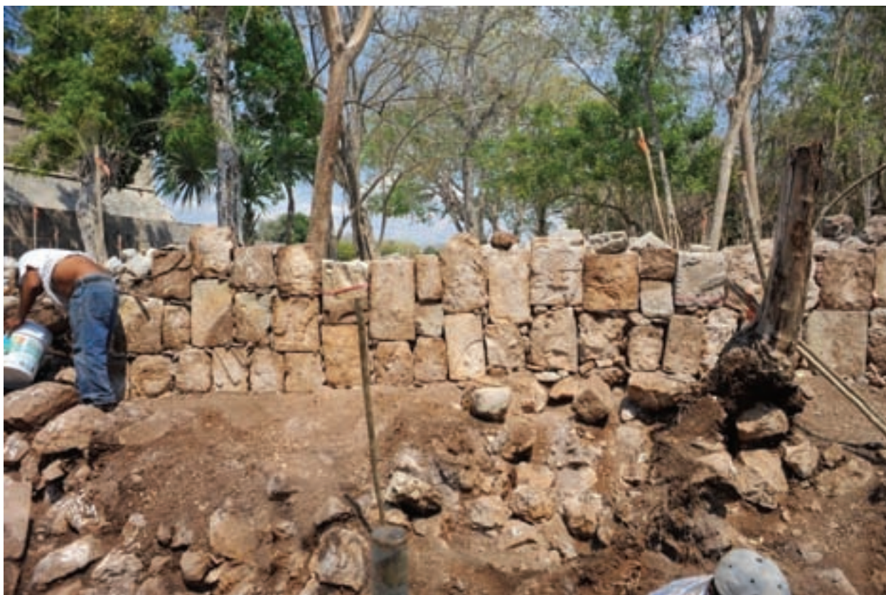
Figura 1.20. Etapa constructiva X, contrafuerte de la Muralla Rasgo AB1. Notar las piedras esculpidas incorporadas en el muro, que no fue estucado.
