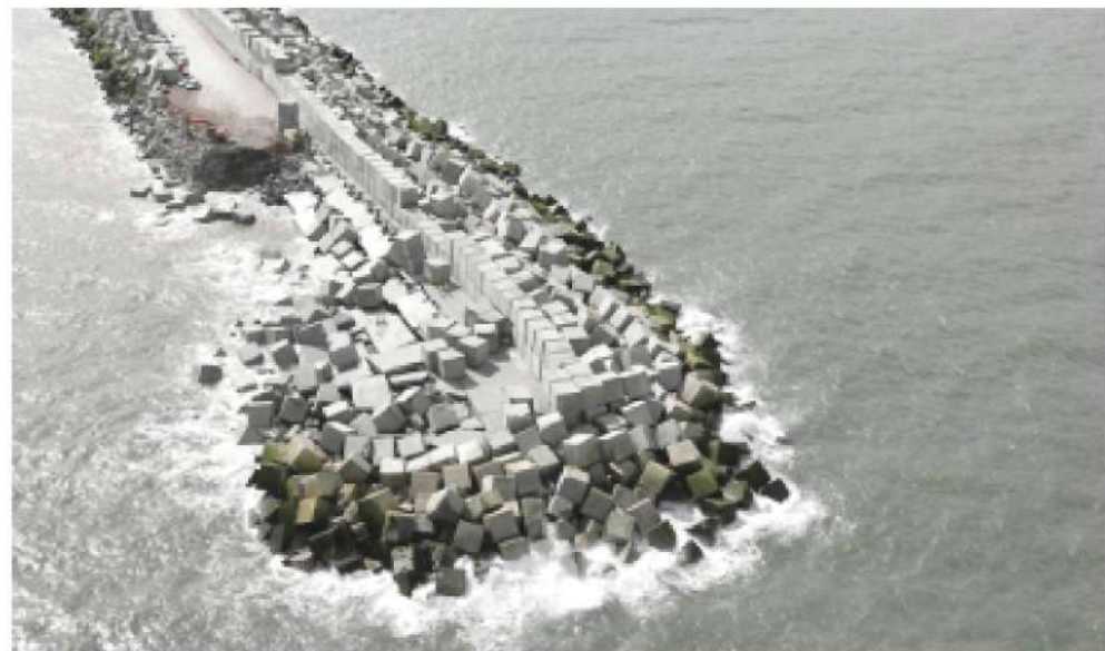
FIGURA 7. Avería de Cabo Torres en Marzo 2007. Manto de cubos.
