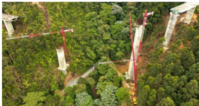
Llegada: La LTM 1220-5.2 ha llegado a su lugar de operación e instala una grúa torre.
