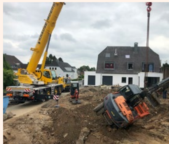
Una vez que se han localizado los puntos de conexión correctos, la Tadano ATF 100G-4 pudo levantar y salvar la excavadora.
