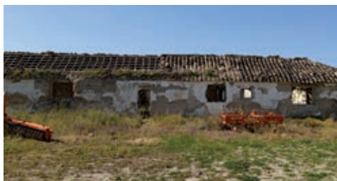
Fig. 202: El deterioro y derrumbe de cortijos y otras construcciones agrarias impide que especies como la carraca europea, el cernícalo primilla, la lechuza común o el mochuelo europeo, puedan usarlos para reproducirse.
