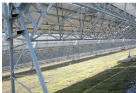
Fig. 11: Planta termosolar. Las plantas solares ocupan intensamente las superficies abiertas.
