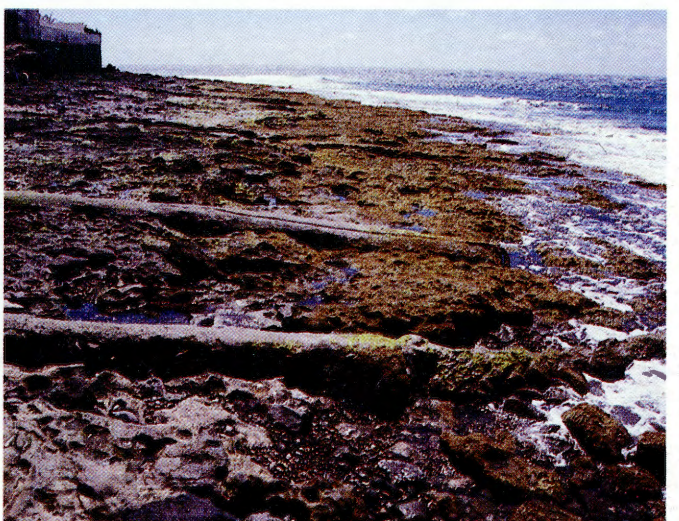
Emisarios sobre rasa intermareal (Arinaga, Gran Canaria).
