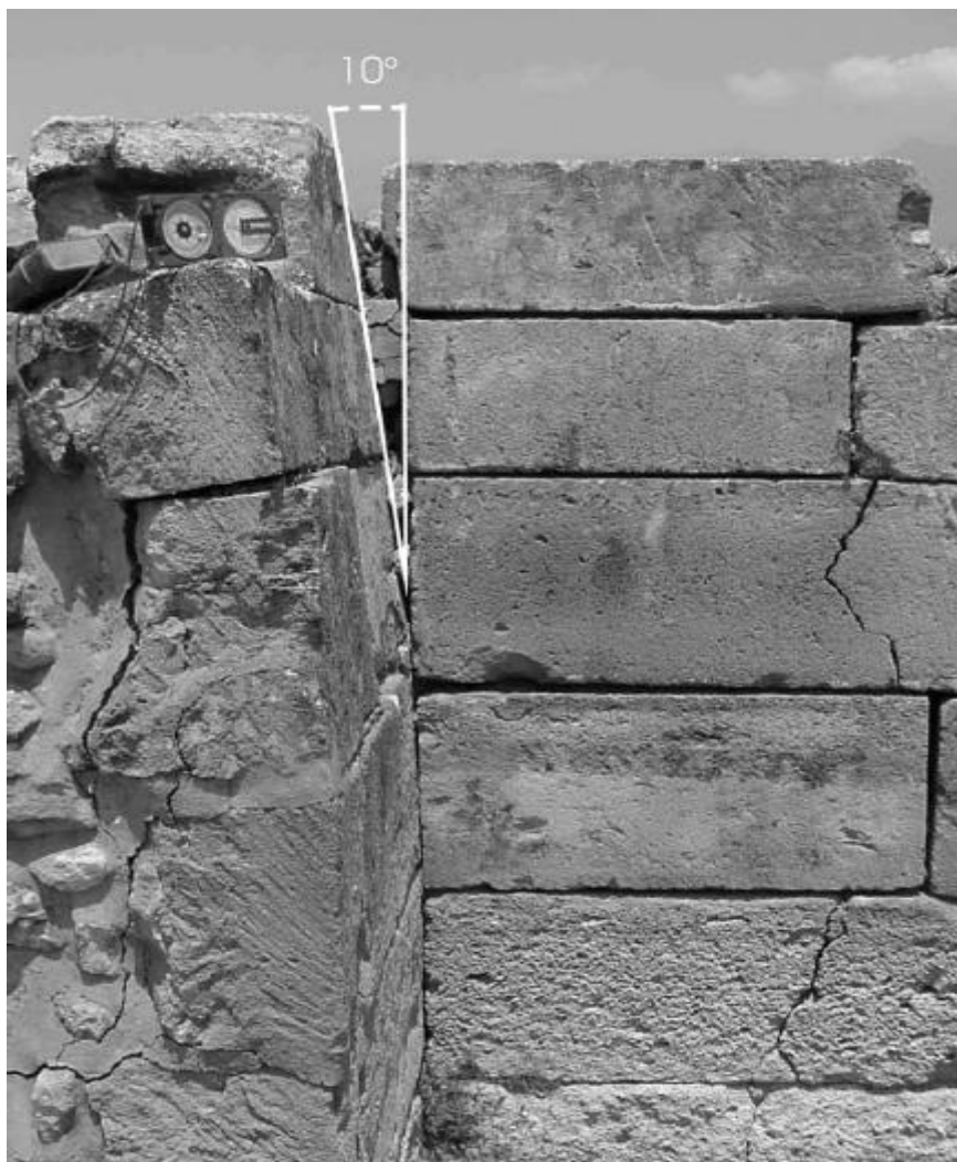
Obrázek 37: Vychýlená zeď v severozápadním křídle vily (zdroj: Monaco - Tortorici 2004, 112 )
