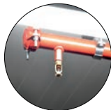
Detalle de rociador.
