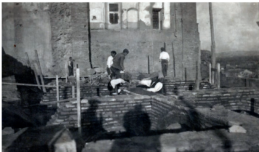
Fig. 10. Reconstrucción de las dependencias conventuales tras el hundimiento acaecido en 1922. Foto Archivo Javier Lavena.
