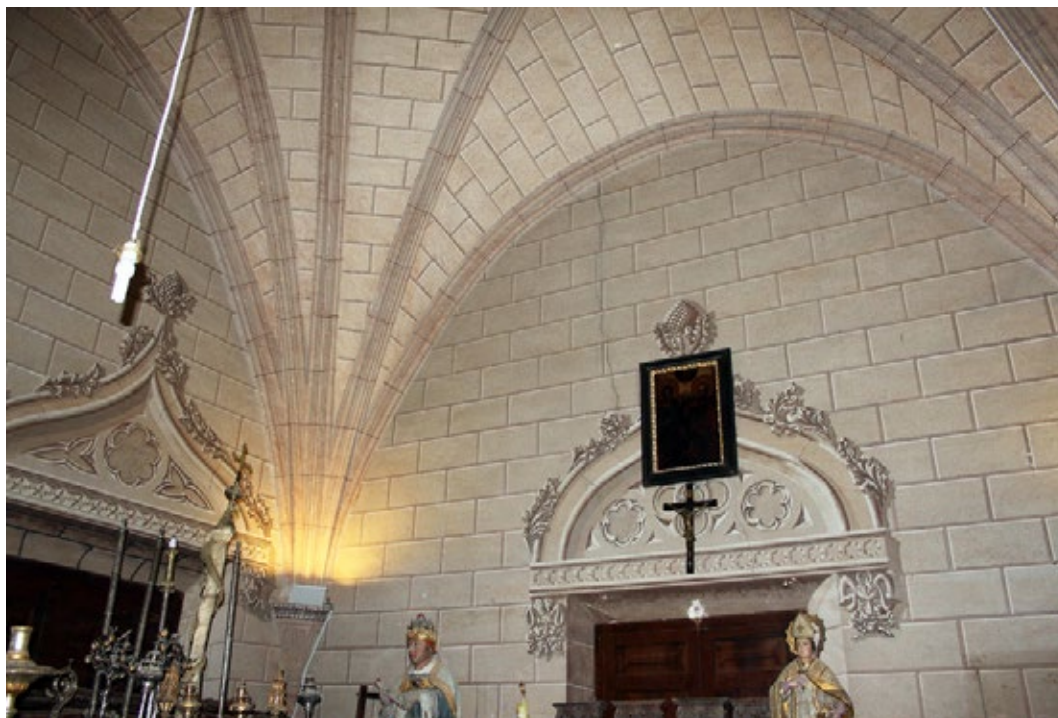
6. Vista de la decoración pictórica de la sala capitular. Catedral de Santa María de la Huerta de Tarazona. Foto Rebeca Carretero.
