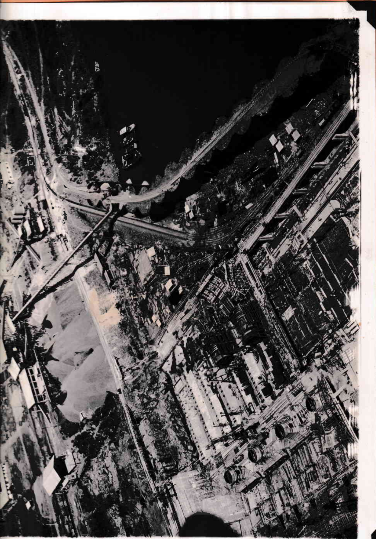
VISTA DE LA MARGEN DERECHA CON EL MONTAJE DE LOS TUBOS DE PRESION III Y IV.- Febrero de 1939.-
