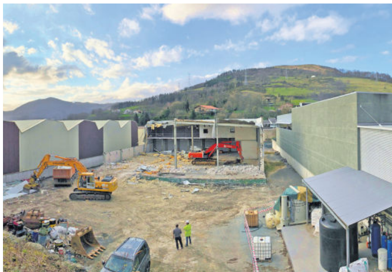
Imagen de preparación de la zona de ampliación junto a sus instalaciones.
