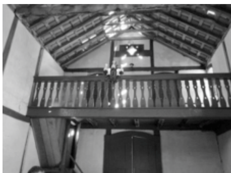
Imagem 07 Telhado da igreja. Várias telhas desceram permitindo passagem da iluminação do sol como pode ser observado. Fonte: Acervo dos pesquisadores Vandeir José da Silva e Giselda Shirley da Silva.
