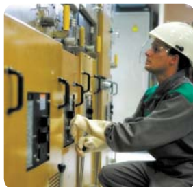
Puesta en Marcha de instalaciones eléctricas
