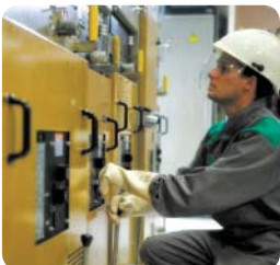
Puesta en Marcha de instalaciones eléctricas
