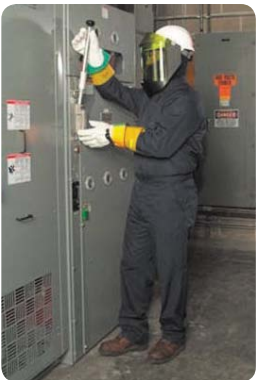
Equipo de Protección Personal, Nivel 2, determinado en estudio de Arc Flash.
