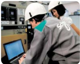
ProDiag, Diagnóstico del funcionamiento de un interruptor de potencia en MT.
