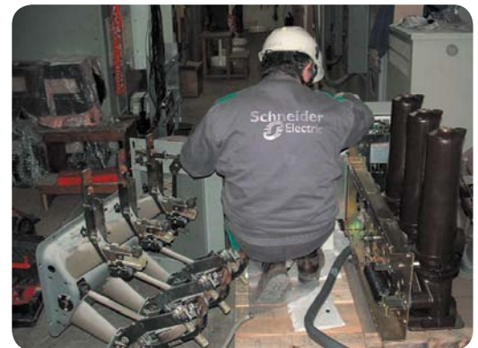
ECOFIT de un interruptor en MT.
