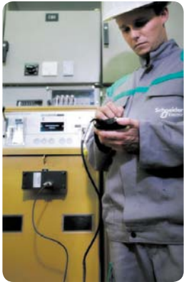
Pruebas de equipos
