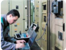
ProSelect, Diagnóstico de la unidad de disparo de un interruptor en aire en BT.
