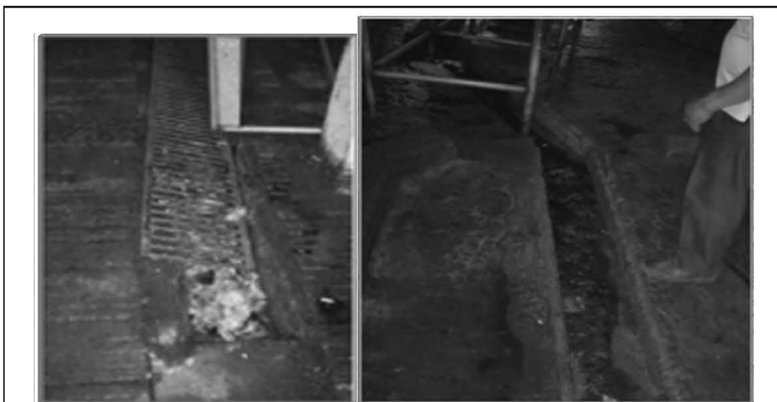
Figura 57. Sistema de disposición final de la sangre del Centro de Faenamiento del GAD Municipal de Mejía
