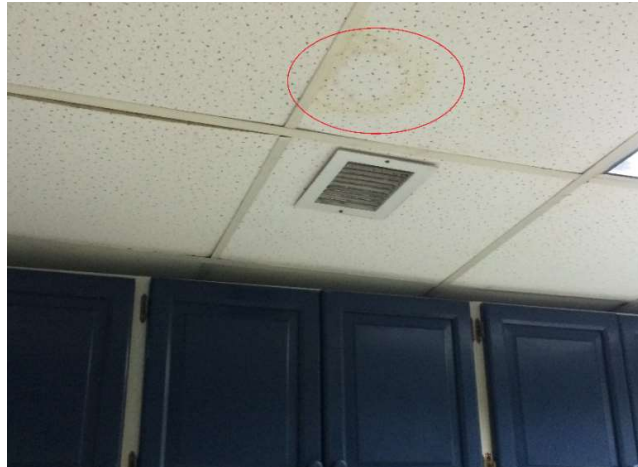
Figura 1.76: Manchas en cielo raso debido a goteras.
