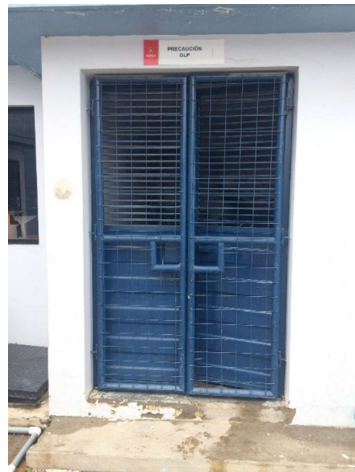
Figura 1.19: Seguridad del lugar de distribución y almacenamiento de cilindros de gas licuado.
