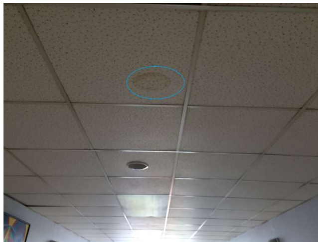
Figura 1.77: Manchas en cielo raso debido a goteras.
