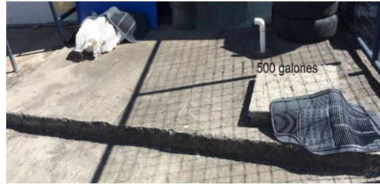
Figura 1.58: Tanque de reserva de diésel exterior de 500 galones.
