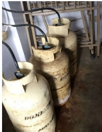
Figura 1.59: Cilindros de gas licuado de petróleo.
