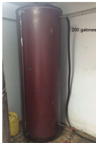
Figura 1.57: Tanque de reserva de diésel interior de 200 galones.
