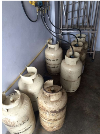
Figura 1.18: Lugar de distribución y almacenamiento de cilindros de gas.
