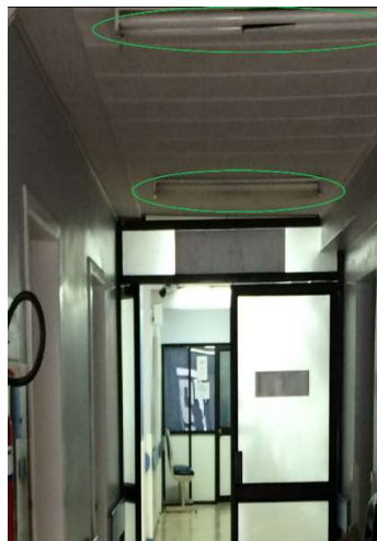
Figura 1.83: Sistema de iluminación interna de la casa de salud.
