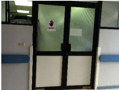
Figura 1.62: Seguridad de áreas críticas.
