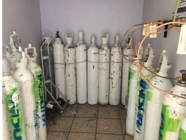
Figura 1.16: Cuarto de distribución y almacenamiento de cilindros de oxígeno.
