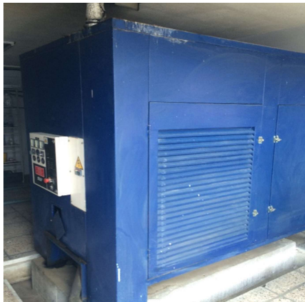
Figura 1.47: Generador de energía eléctrica.
