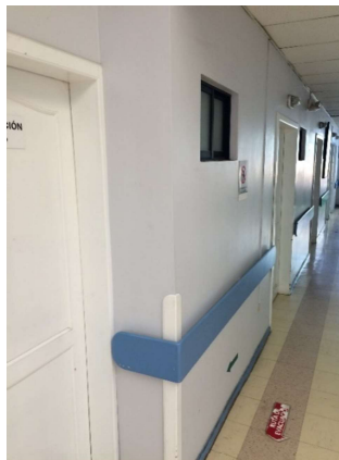
Figura 1.21: Ruta de evacuación con iluminación de emergencia.
