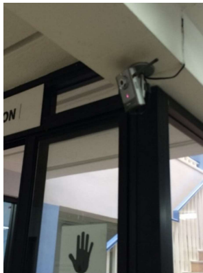
Figura 1.51: Cámara de seguridad instalada en el hospital.
