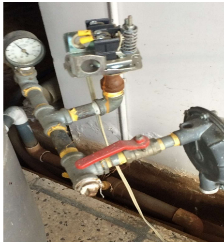
Figura 1.55: Ingreso de agua al tanque hidroneumático.
