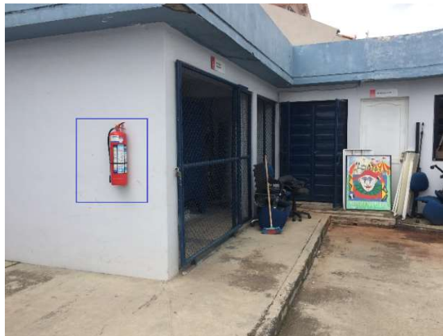
Figura 1.85: Extintor en el área de mantenimiento.
