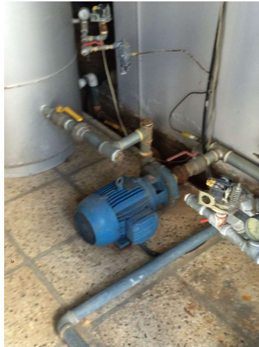
Figura 1.56: Bomba del sistema de agua potable.
