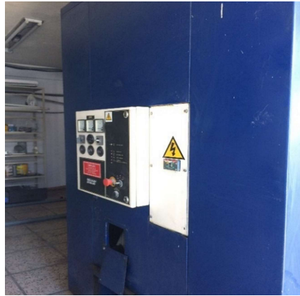
Figura 1.48: Generador de energía eléctrica.
