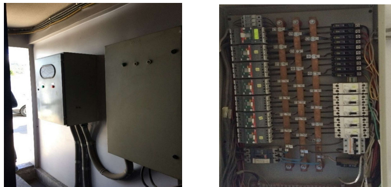
Figura 1.49: Tablero de control.
