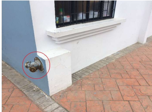
Figura 1.86: Salida de agua para emergencias.
