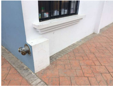
Figura 1.20: Toma de agua en el exterior de la entidad hospitalaria.
