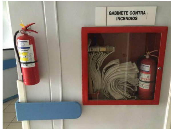
Figura 1.23: Gabinete contra incendios en la planta baja.
