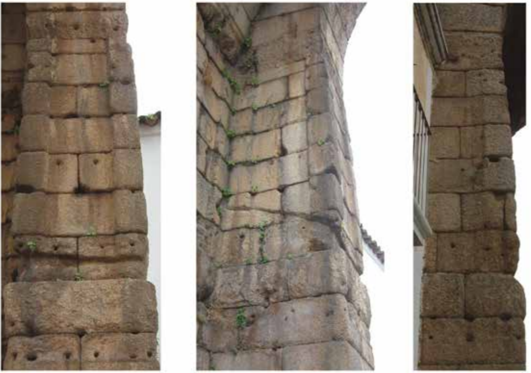
Fig. 27 Detalle de los marcos rectangulares de las distintas caras de las jambas del arco
