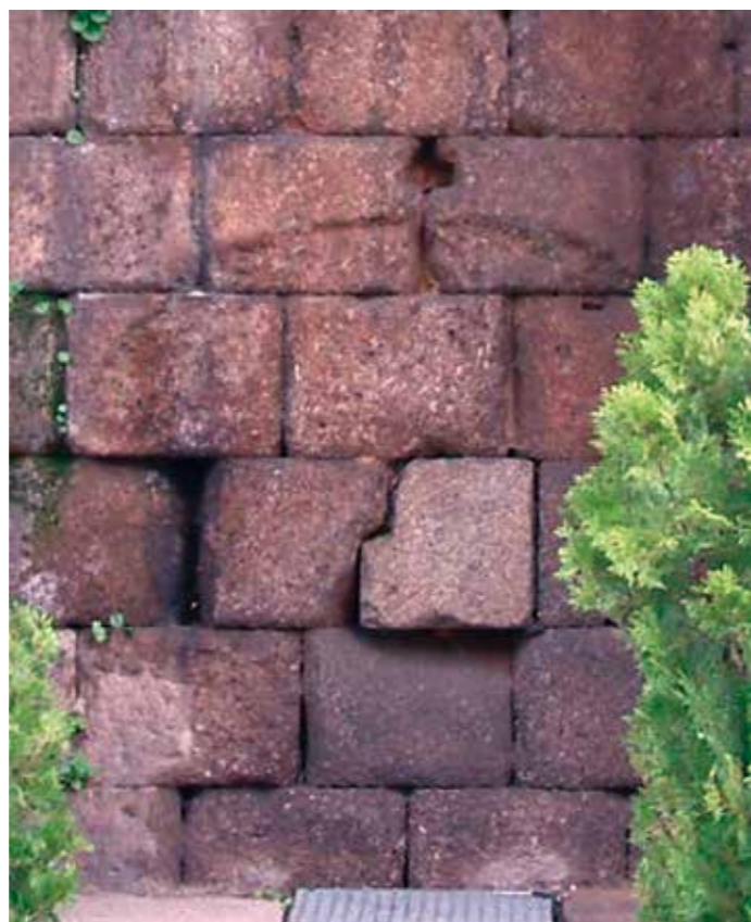
Fig. 64 Detalle de la presencia de un posible techo adosado a la jamba SO del arco
