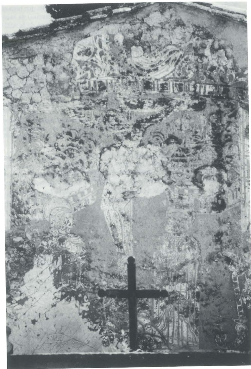
FIG. 3. Restos de esgrafiados de la cabecera.
