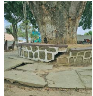
El parque del "Palo del Amor" está en ruinas, abandonado por décadas convertido en botadero de basura y en tiempo de lluvia se inunda.
