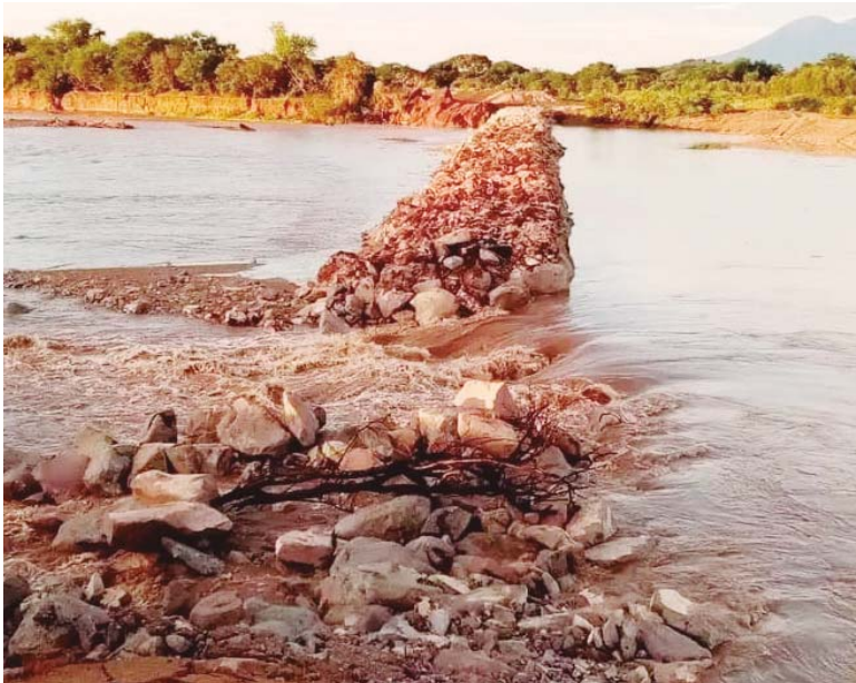
Esta fue la borda que estaba construyendo la SIT y que fue destruida por la primera crecida del río Goascorán, a mediados de septiembre pasado.
