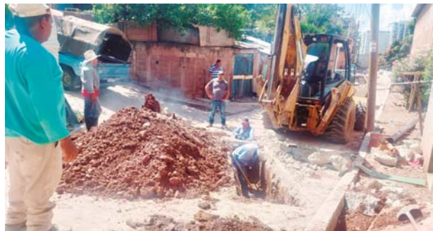
Por las lluvias varios tubos se desacoplaron en el Reparto por Arriba, pero con los trabajos se subsanaron filtraciones de aguas residuales.
