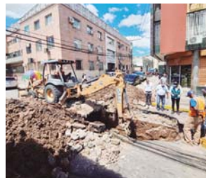
Las autoridades edilicias también realizaron la reparación de una tubería en la calle localizada a un costado de la Secretaría de Salud, en el barrio El Jazmín, de Tegucigalpa.
