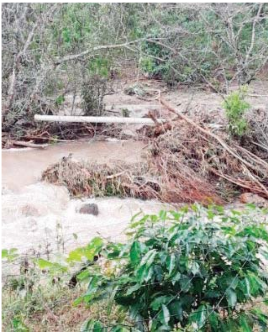
Se destruyeron unos 400 metros lineales de tubería PVC de ocho pulgadas que transporta agua cruda desde la obra de captación a la planta de tratamiento "Guaratoro".
