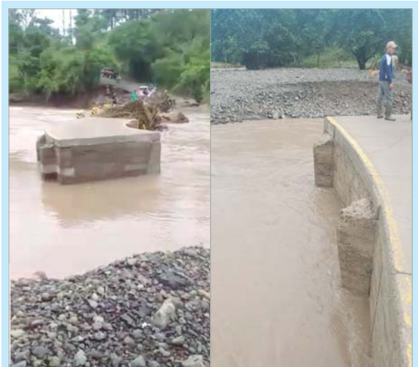
El desbordamiento del río Guayape también destruyó varios puentes y pasos, incomunicando muchas zonas.
