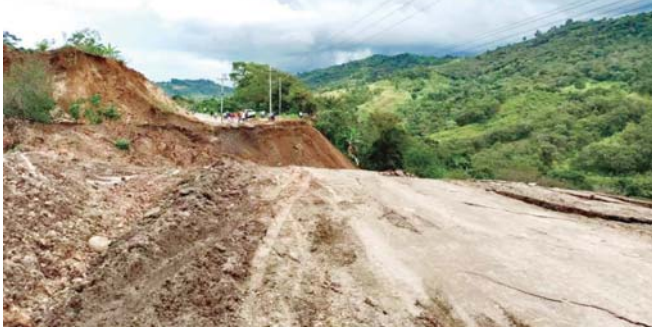
La falla de El Metal partió la carretera.
