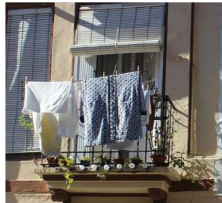
Añadido de elementos inadecuados.
