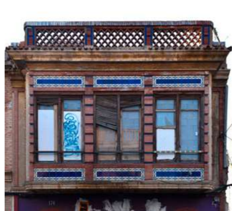
Suciedad, manchas y roturas.
