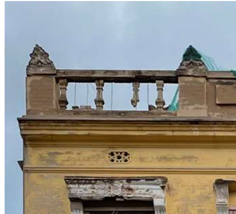
Pérdida y rotura de elementos.
