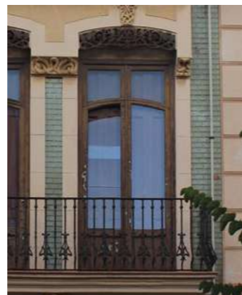
Deslizamiento del vidrio.
