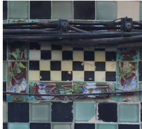
Pérdida volumétrica del tubat .
