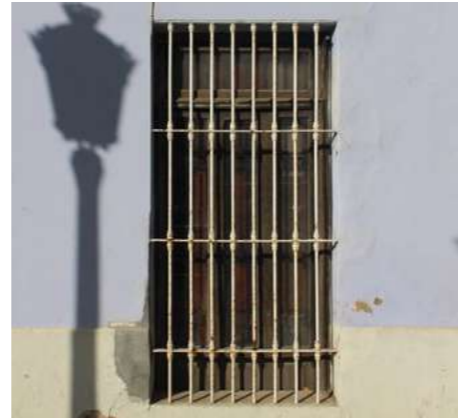
Ocultación, tapado o corte de la rejería.
