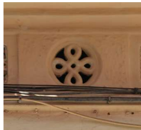
Pérdida de textura.
