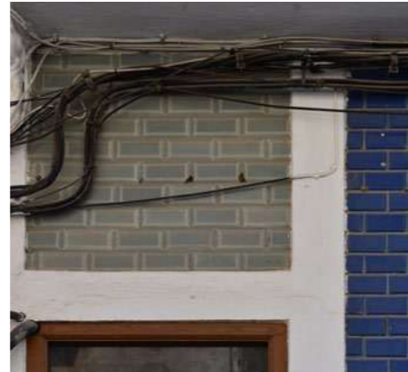
Instalación de elementos impropios.
