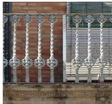
Sustitución inapropiada de faltas.
