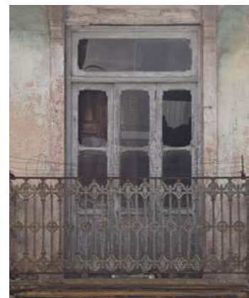
Pérdida de la capa protectora.
