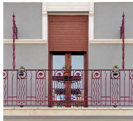
Aplicación de pinturas impropias.
