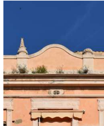
Faltas parciales o totales.
