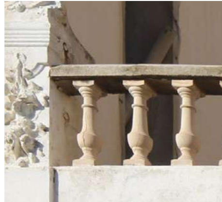
Fisuración por oxidación del armado.
