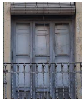
Rotura del vidrio.
