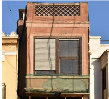
Mirador apuntalado y enmallado.
