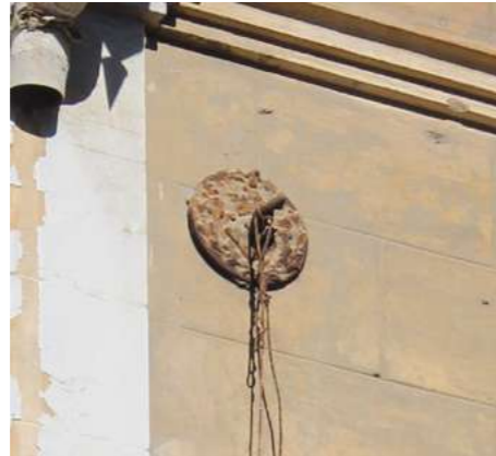
Oxidación de ganchos con escudo.
