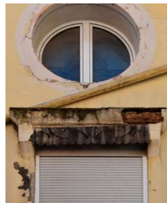
Manchas y roturas.
