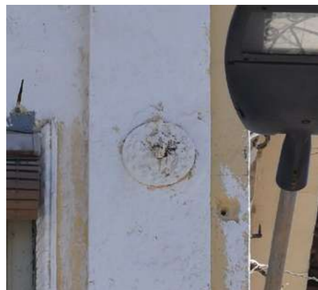
Aplicación de pinturas impropias.
