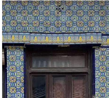
Desprendimientos y movimientos.
