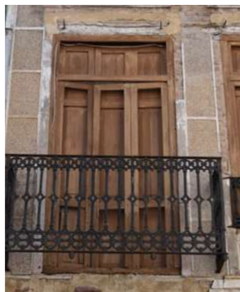
Pérdida de los vidrios.
