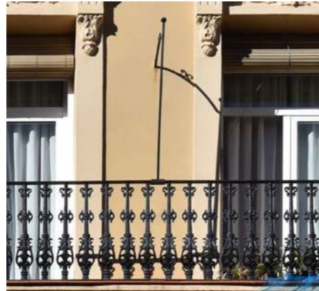
Desplome de la riostra.
