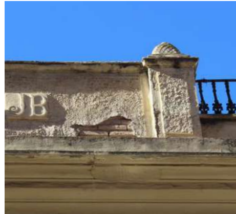
Pérdida de revestimiento.
