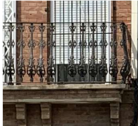
Rotura o pérdida de elementos.
