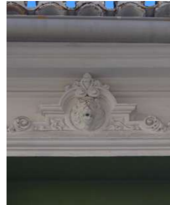
Acumulación de suciedad.
