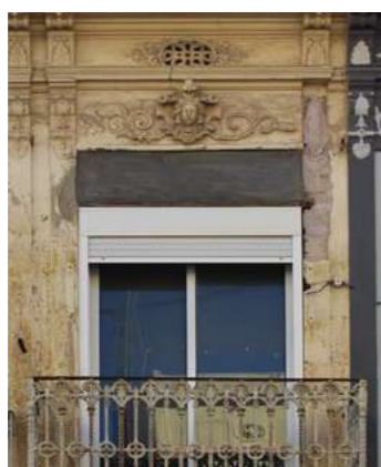
Reparaciones con mortero sin reposición del volumen.
