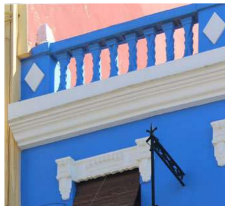
Revestimientos no adecuados.
