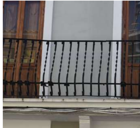
Rotura y deformación de elementos.
