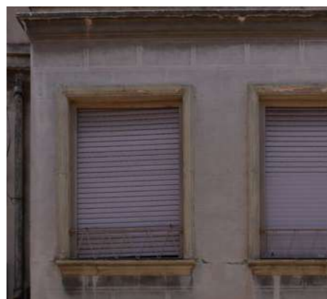
Humedades siguiendo el despiece.
