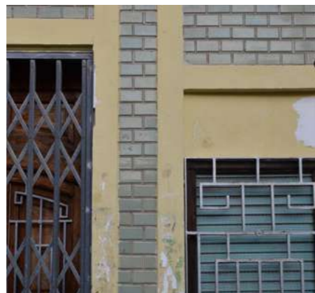
Colocación de rejería impropia.
