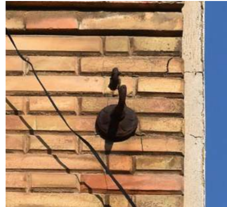
Oxidación de ganchos.
