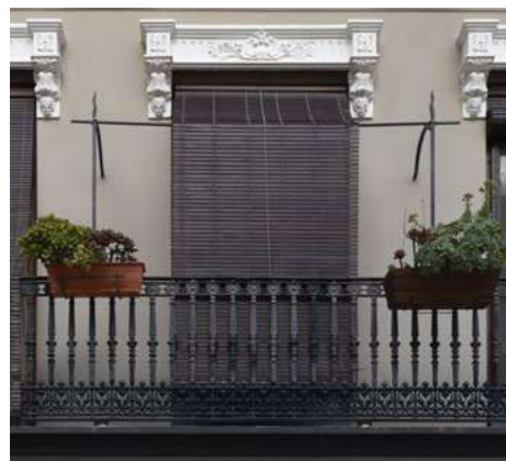
Adición de elementos impropios.
