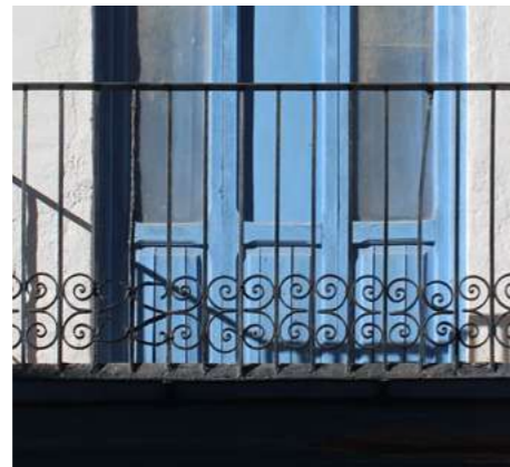
Sustitución inapropiada de faltas.
