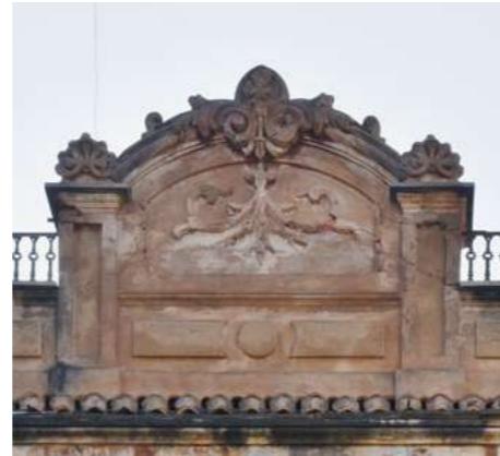
Manchas y suciedad.
