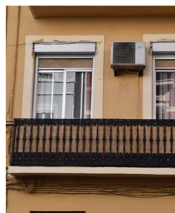
Modificación del hueco con carpinterías impropias.
