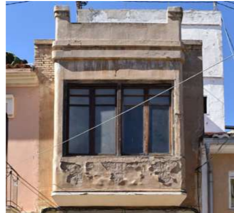
Pérdidas de revestimiento.
