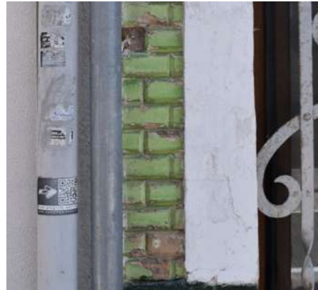
Arenización y pérdida de volumen.
