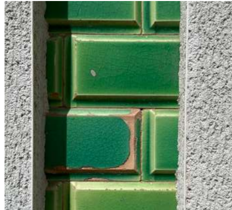
Desprendimiento del vidriado.
