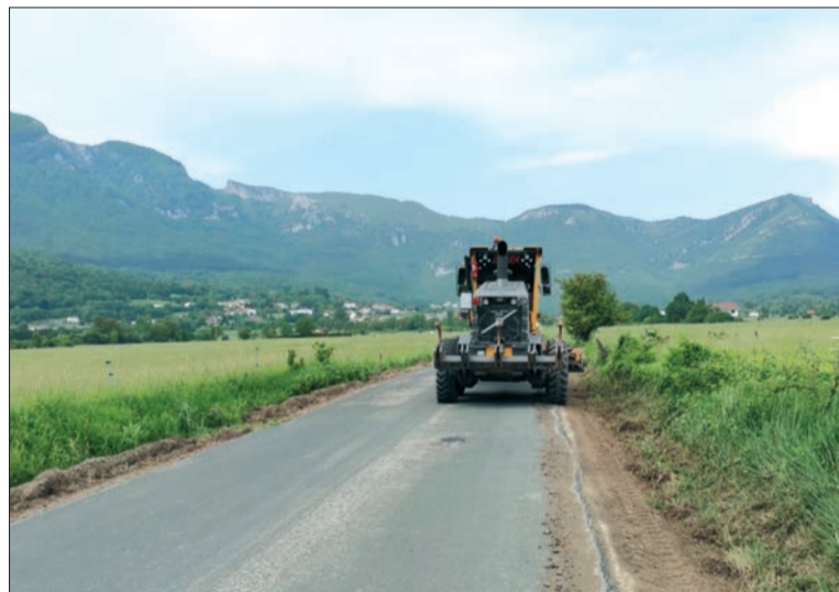
Motoniveladora repavimentando cunetas de la BU-V-5433 el 20 de mayo en la recta de Sopeñano.
