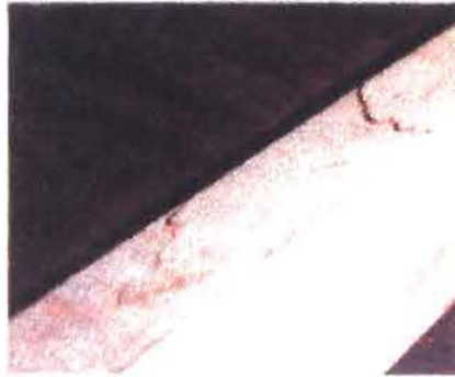
Figura 9. Escamadura o acebolladura.
