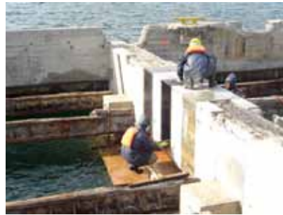
2. Reforzamiento a cortante de las vigas de un muelle con el tejido de fibra de carbono SikaWrap®-600C .
