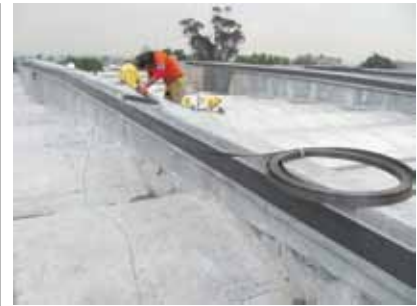
3. Reforzamiento a flexión de las vigas de la cubierta de un estadio con las platinas de fibra de carbono Sika CarboDur®-S512 .
