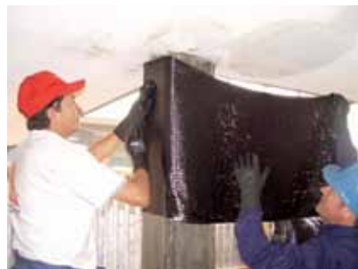
5. Reforzamiento a cortante de las columnas de una escuela con el tejido de fibra de carbono SikaWrap®-600C .
