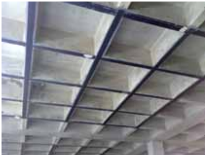
1. Reforzamiento a flexión de una losa de un edificio con platinas de fibra de carbono Sika CarboDur®-S1012 .
